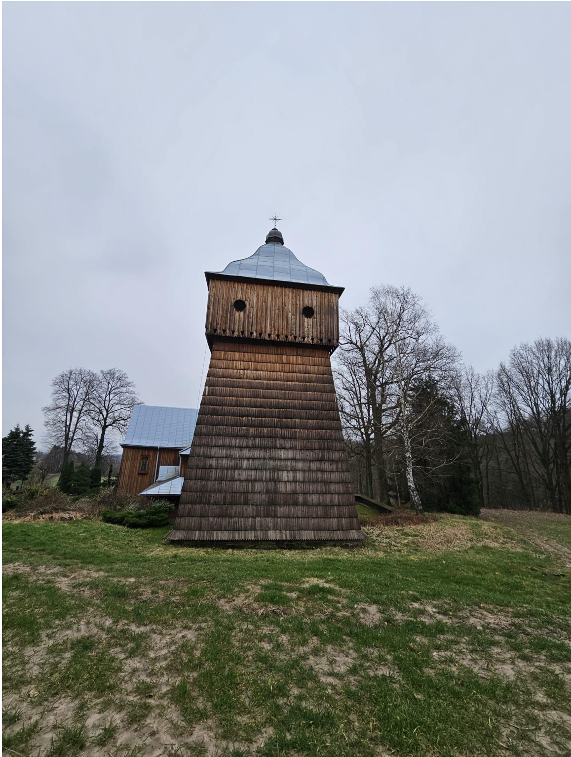
Widok ogólny stanu zachowania blaszanego pokrycia dachu dzwonnicy – strona zachodnia
