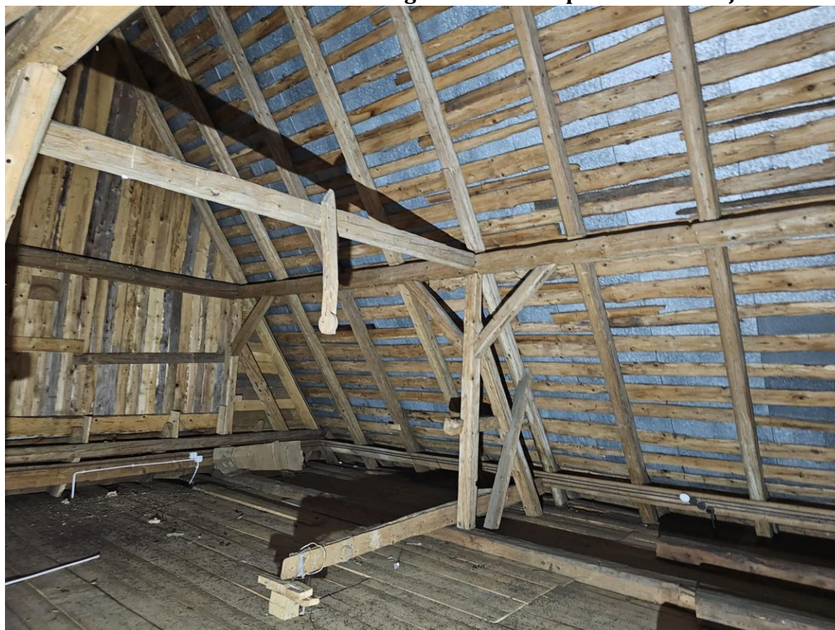
Widok stanu zachowania ażurowego deskowania połaci dachowej
