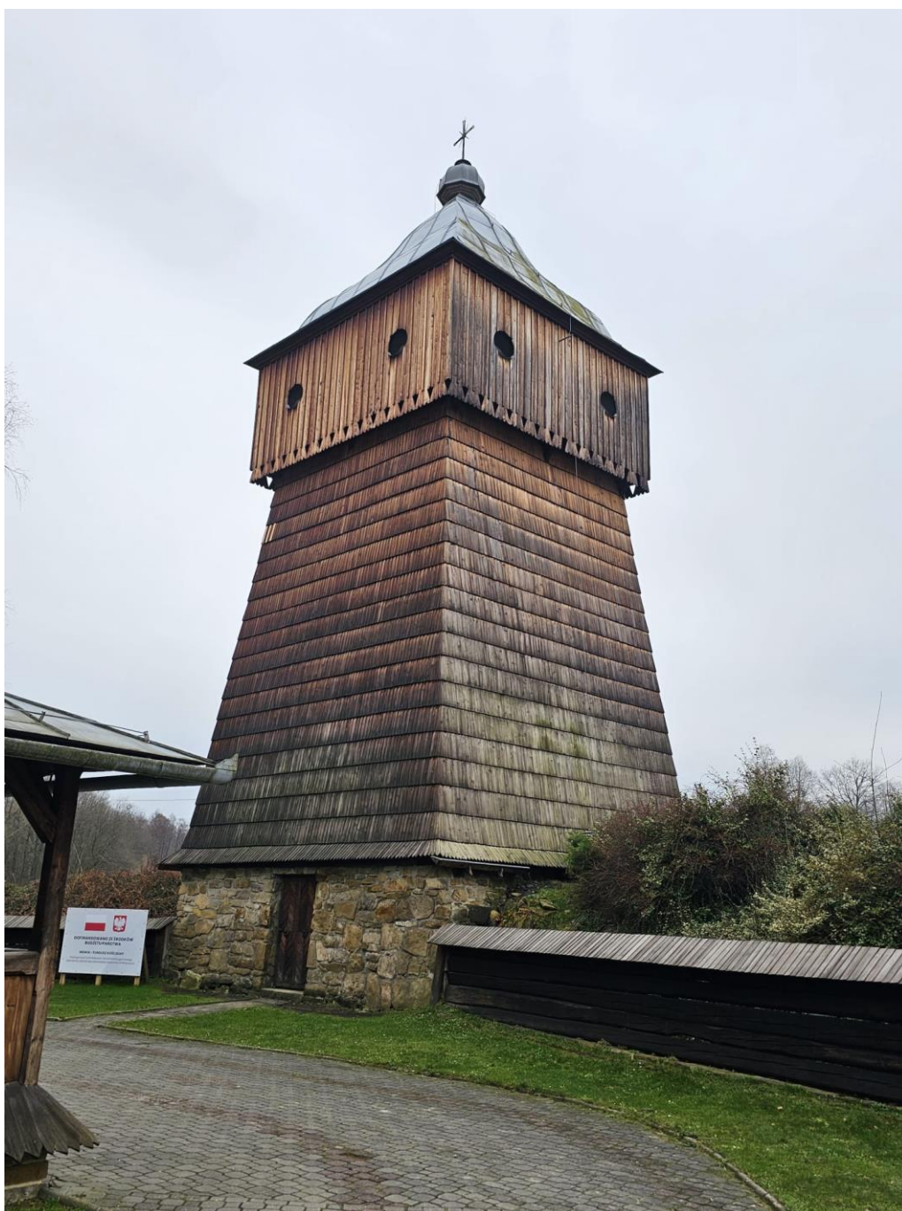
Widok ogólny stanu zachowania blaszanego pokrycia dachu dzwonnicy – strona północno wschodnia
