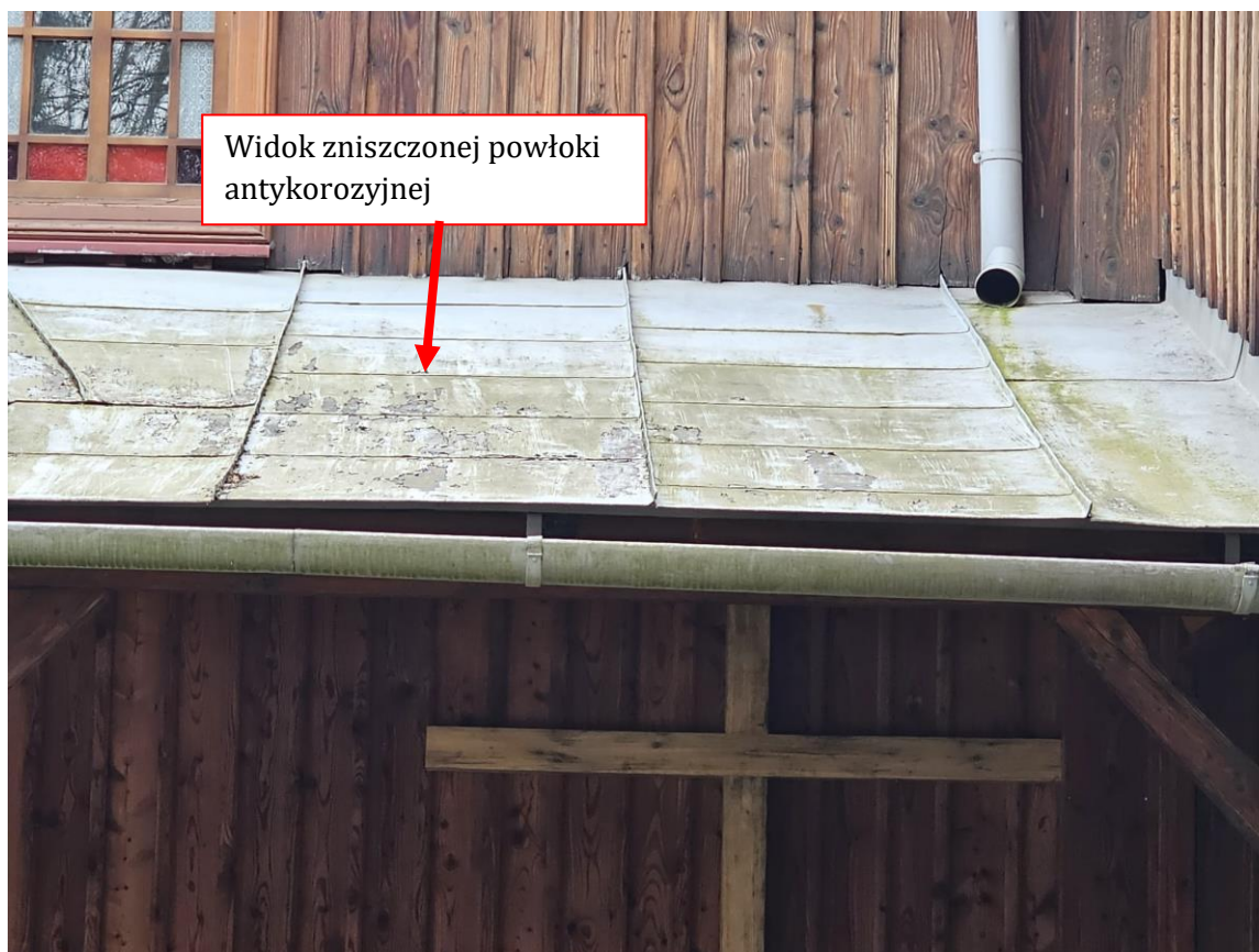
Szczegółowy widok stanu zachowania blaszanego pokrycia dachu sobót – strona południowa
