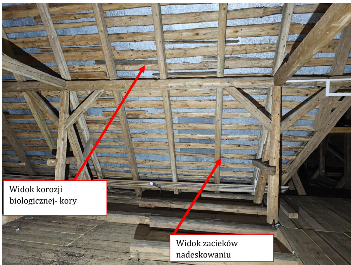
Widok stanu zachowania ażurowego deskowania połaci dachowej
