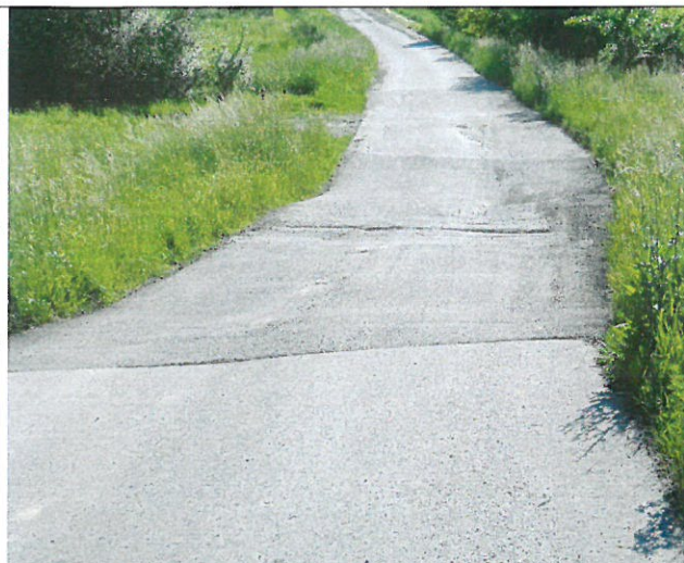
Zniszczona droga gminna w środkowej części osuwiska
